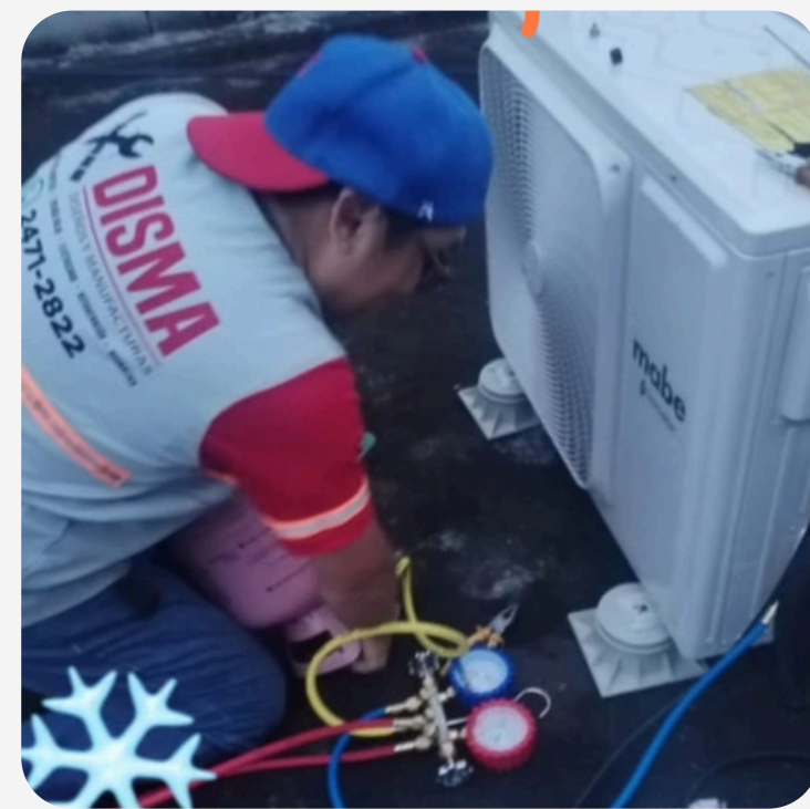
Mantenimiento de aires acondicionados
