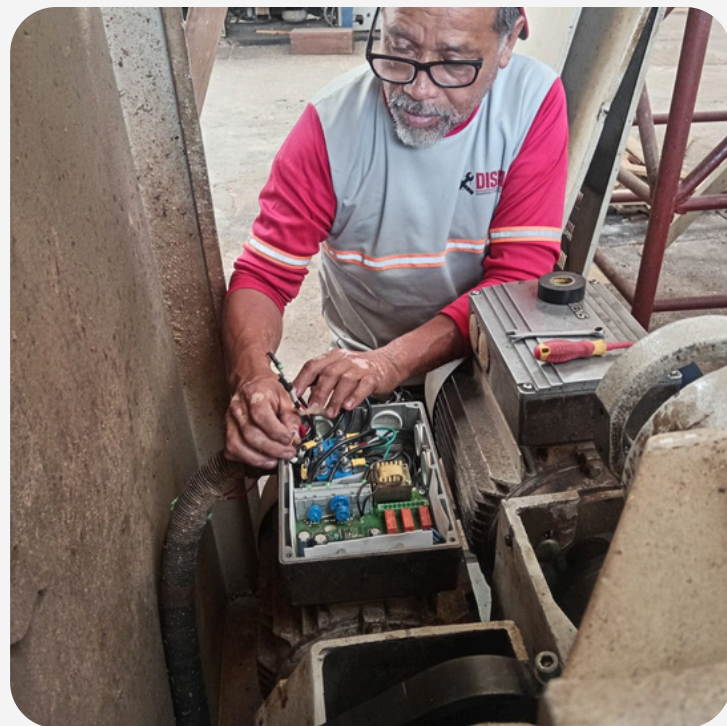
Diagnostico de maquinaria
