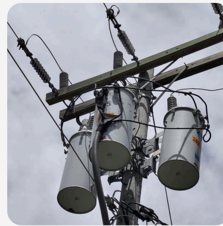
Banco de transformadores
