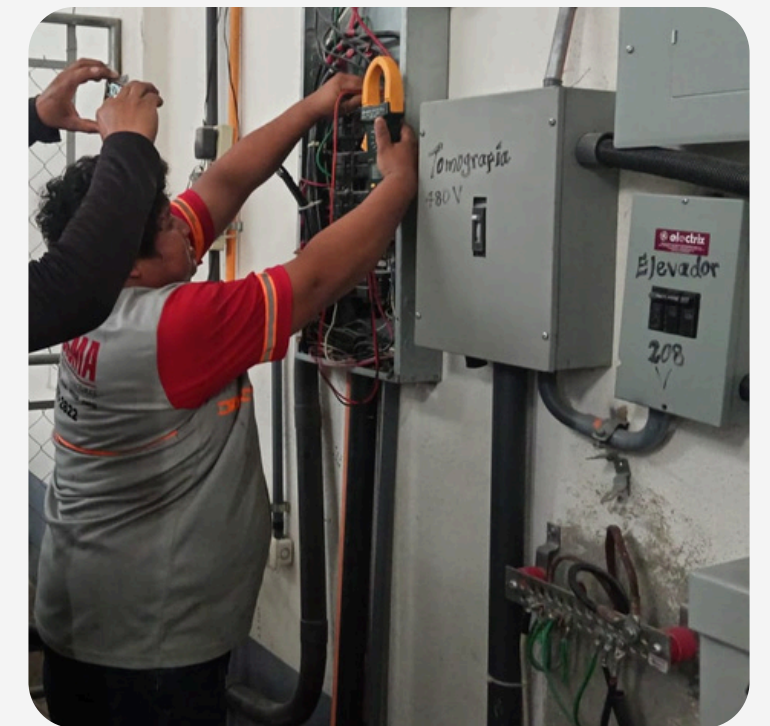
Mediciones de tablero de distribucion
